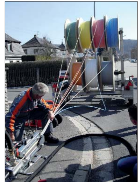
Bild 3: Mit geeigneten Geräten können auch mehrere Mikrorohre gleichzeitig eingeblasen werden (Quelle: Bagela)
