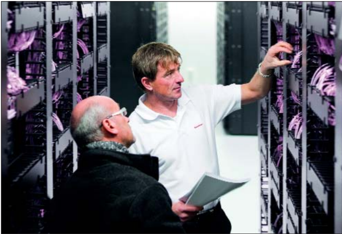
Die Aktivtechnik eines Datacenters wird in der Regel alle drei Jahre ausgetauscht und muss dabei neu installiert und verkabelt werden
