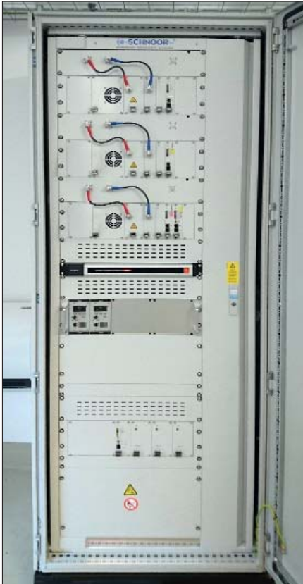
Bild 2: DMR Compact Repeater Tier 2, installiert in Lohme und Gören
