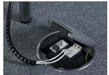
Bild 3: Bodentank mit eingebautem FTTO-Switch
